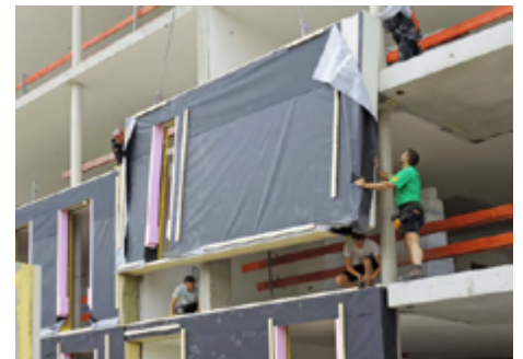
Imagen N°2: Montaje de paneles de fachada- personal de obra sin EPP. Fuente: Reto Kommerling (2023).
