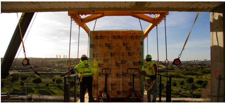
Imagen N°7: Instalación robotizada de almacenamiento Lignum Tech. Fuente: Eje Prime, 2025.
