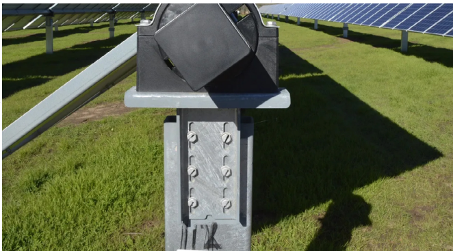
Imagen N°1 ; Seguidor solar de 125 MW en Australia. Fuente:DGIT, 2023
