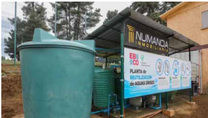
Imagen 2: Sistema de tratamiento y reutilización de aguas grises en instalación de faenas. Fuente: CDT, 2023.
