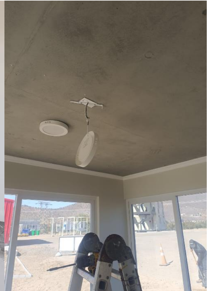
Instalación eléctrica Momentum
