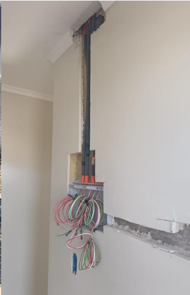
Instalación eléctrica Momentum
